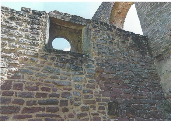
Abb. 26: Die Restaurierung orientiert sich am Bedarf, so stehen gesicherte und unbearbeitete Fugenflächen direkt nebeneinander
