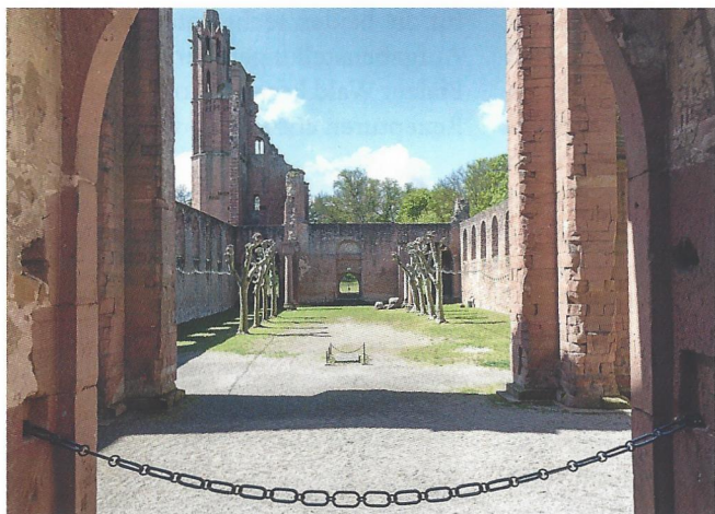
Abb. 22: Ziel der Arbeiten auf der Ruine Limburg war der Erhalt des Bestands mit möglichst minimalen Eingriffen
