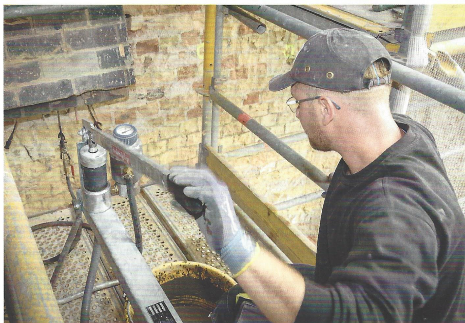
Abb. 8: Mit einer Handhebelpumpe wurden rund drei Liter Mörtel in jedes Ankerloch verpresst.
