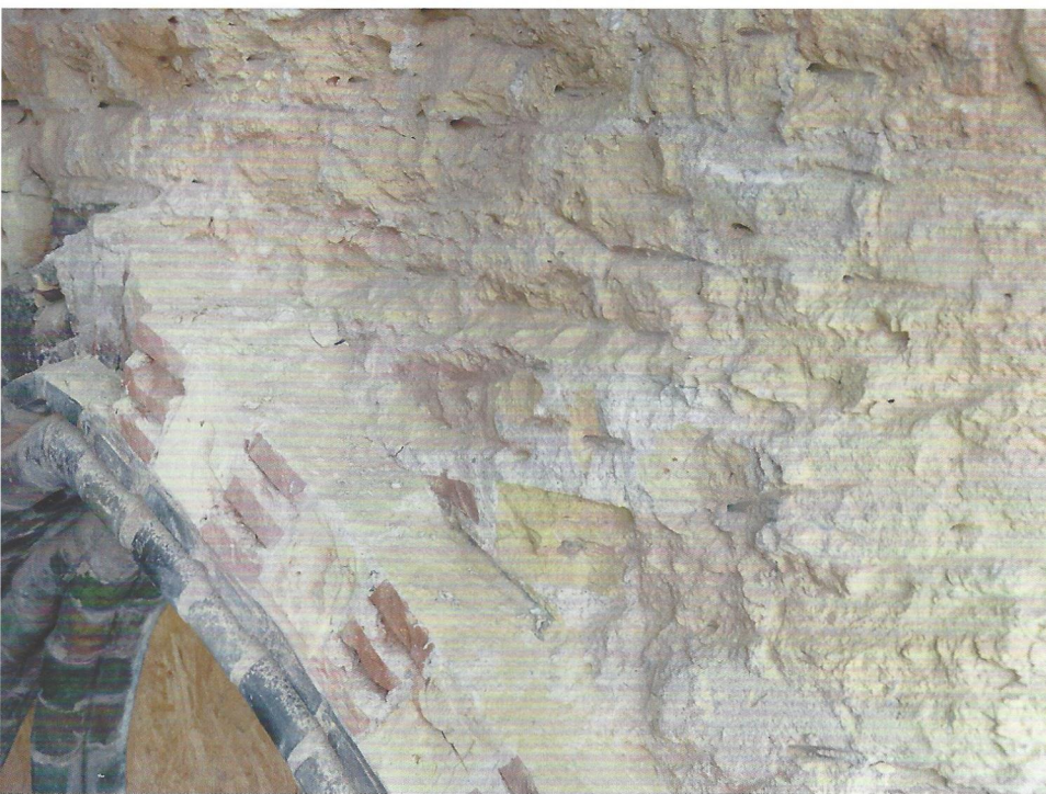
Abb. 2: An einigen Bereichen des Turms war das Mauerwerk tiefgreifend geschädigt.
