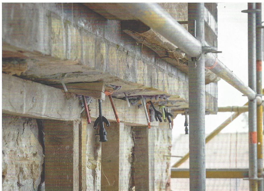
Abb. 7: Eine Vernadelung mit Ankermörtel sichert Bereiche des Vormauerwerks, die nicht neu aufgemauert werden müssen. Die Metallstäbe sind mit zwei Plastikröhrchen bestückt. Durch eines wird der Ankermörtel eingebracht, durch das andere kann die vom Mörtel verdrängte Luft entweichen. Tritt hier Mörtel aus, zeigt das an, dass das Bohrloch vollständig gefüllt ist.
